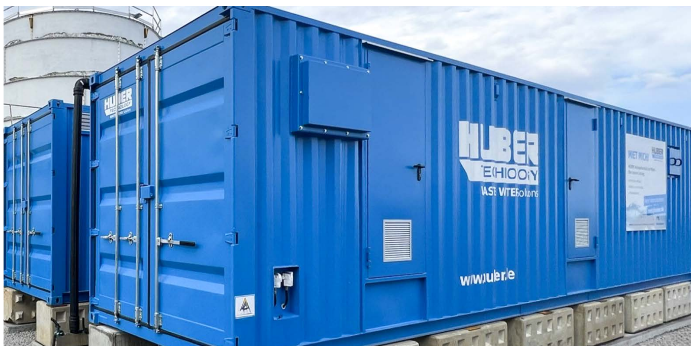
Mietanlage - HUBER Druckentspannungsflotation HDF S8 in zwei 40ft-Container
